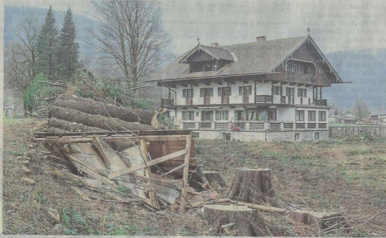
Die Tage des Josefheims sind gezählt: Demnächst wird der Abbruch des alten Gebäudes am Löblweg beginnen. Die ersten Bäume auf dem Areal wurden bereits gefällt. Hier entsteht das neue Oberland Hospiz. FOTO: THOMAS PLETTENBERG
