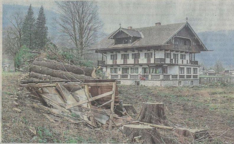
Die Tage des Josefheims sind gezählt: Demnächst wird der Abbruch des alten Gebäudes am Löblweg beginnen. Die ersten Bäume auf dem Areal wurden bereits gefällt. Hier entsteht das neue Oberland Hospiz. FOTO: THOMAS FLETTENBERG
